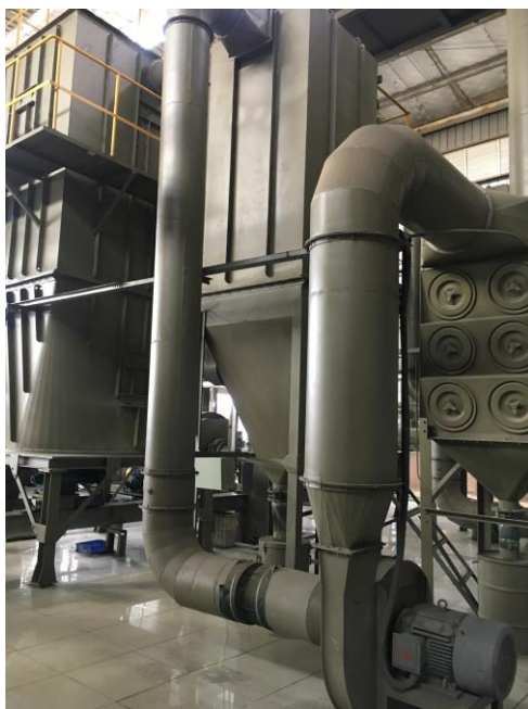
铅粉制备废气处理
