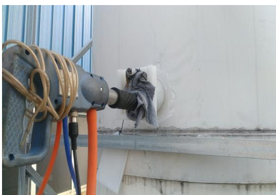
充电车间废气出口
