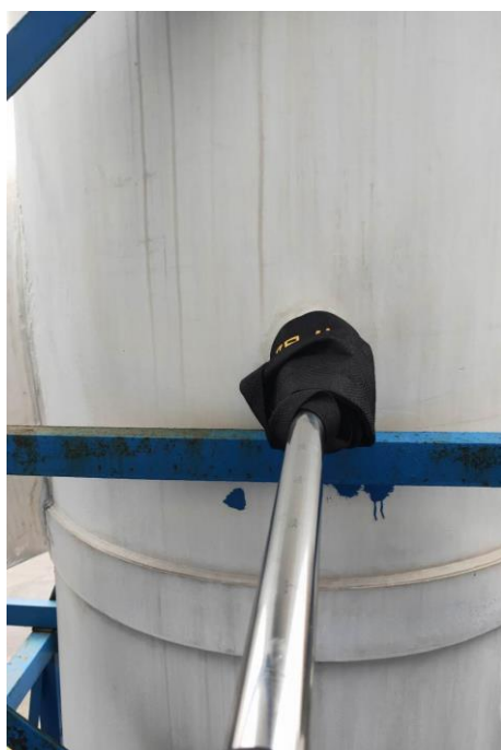
充电车间废气出口
