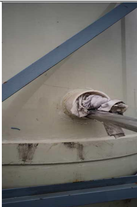
铸焊废气出口
