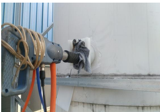
充电车间废气出口
