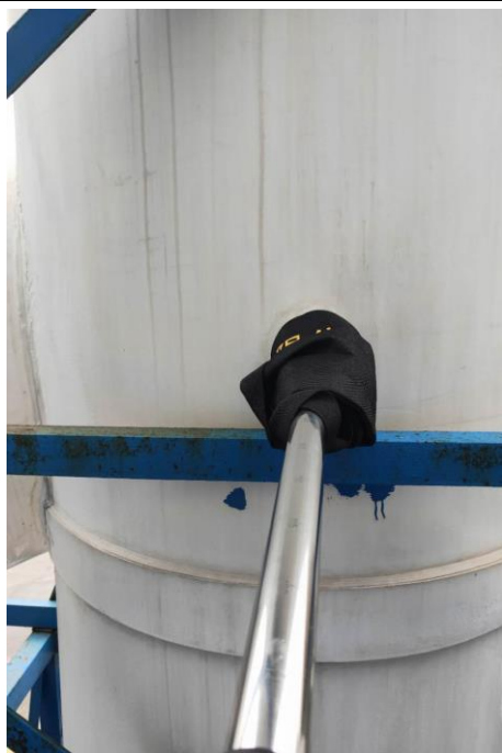
充电车间废气出口
